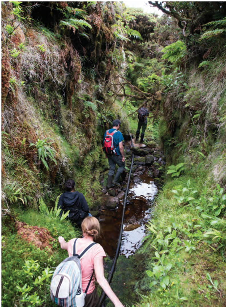
No alto da Serra de Santa Bárbara a Ribeira do Além foi utilizada para passar tubos de abastecimento de água.
